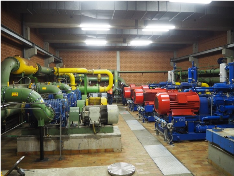
Abb. 6: Grubengasgewinnungsanlage Kohlwald – Innenansicht Maschinenhalle
