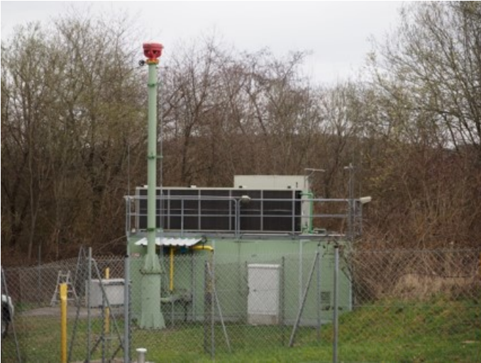
Abb. 7: Grubengasgewinnungsanlage Allenfeld – Außenansicht Containeranlage
