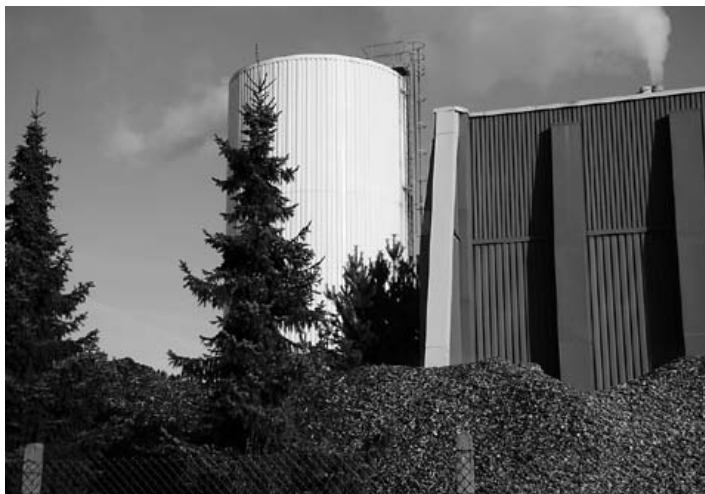
Abbildung 1: Kapazitiver Wärmespeicher der Stadtwerke Rheinsberg GmbH mit einer Speicherkapazität von maximal 25 MWh bei einer maximalen Wassertemperatur von 96 Grad Celsius. Effektives Speichervolumen 716 Kubikmeter.
