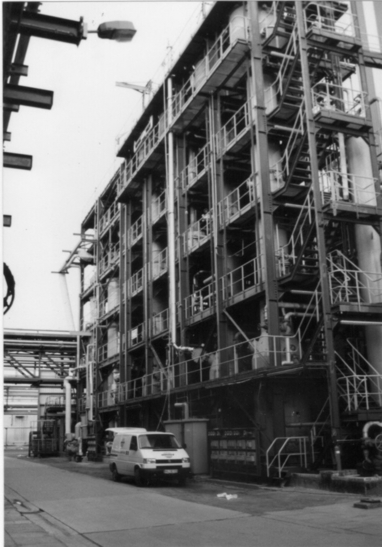
Abbildung 4: Extraktoren im Apparategerüst und angebaurem U-Rohrschenkel (Rohr DN 200) über dem Transporter
